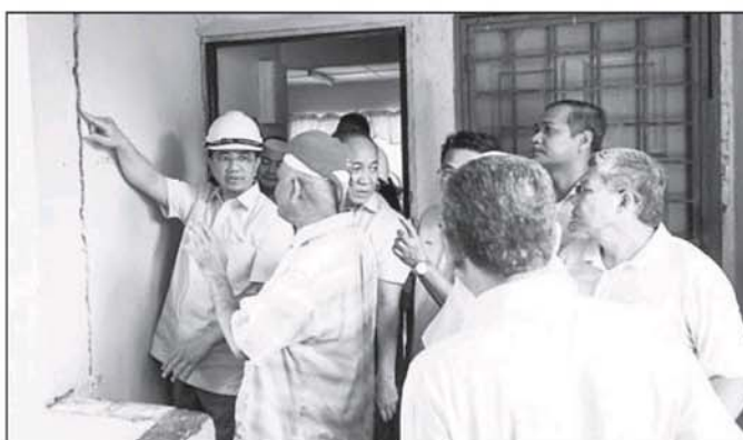
阿兹敏阿里 (左) 实地巡视F座组屋位于5楼呈裂痕的状况。 -马新社-
