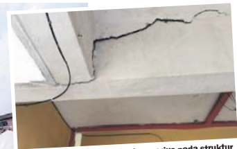
Keretakan serius pada struktur pangsapuri.
