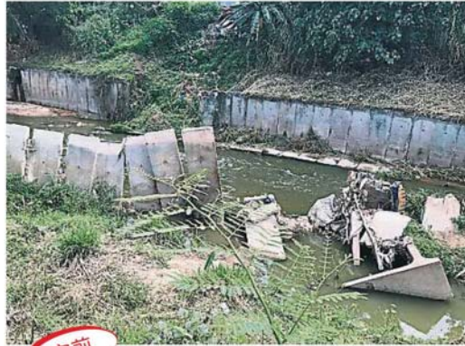
之前 河堤崩裂导致土崩, 使团结花园第20路的居民被迫撤离。
