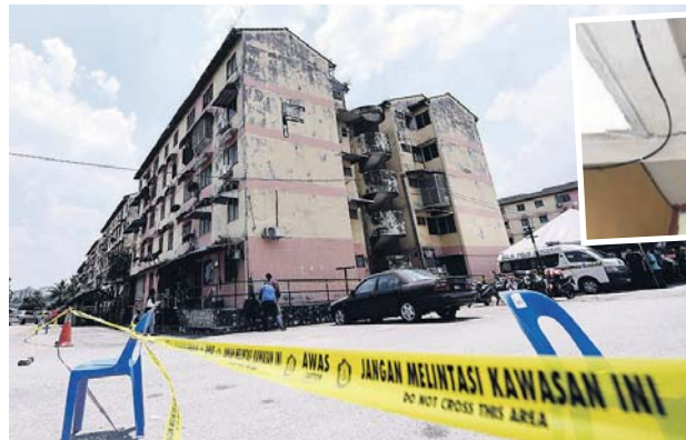
Keadaan Pangsapuri Taman Keramat Permai, Ampang yang dikosongkan penghuninya akibat keretakan teruk.
