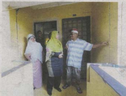
ZURAIDA (dua dari kiri) mendengar penerangan daripada penduduk berhubung keretakan pada Blok F, Flat AU, Taman Keramat Permai, Kuala Lumpur semalam.
